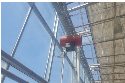
Зураг 75: Дотор байрлах генератор
