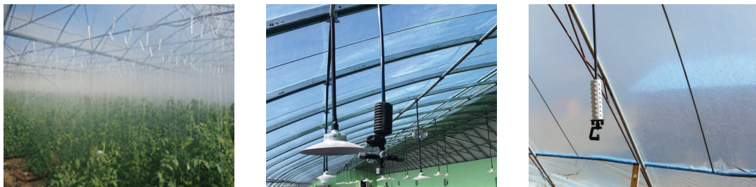
Зураг 63: Мананцар үүсгэж агаарыг хөргөж буй байдал
