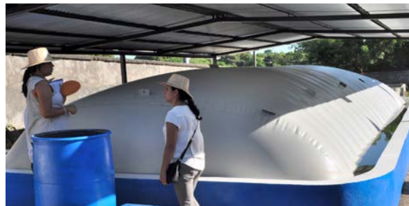
Figura 5: Reactor anaerobio con deflectores (T.3) cubierto con una carpa de membrana
