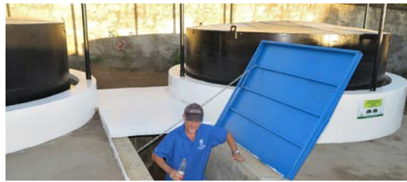
Figura 3: Acceso de servicio al reactor de biogás de campana flotante (T.18)
