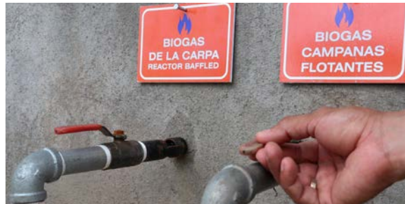
Figura 4: Salida de biogás del ABR con carpa (izquierda) y del reactor de biogás con campana flotante (derecha)
