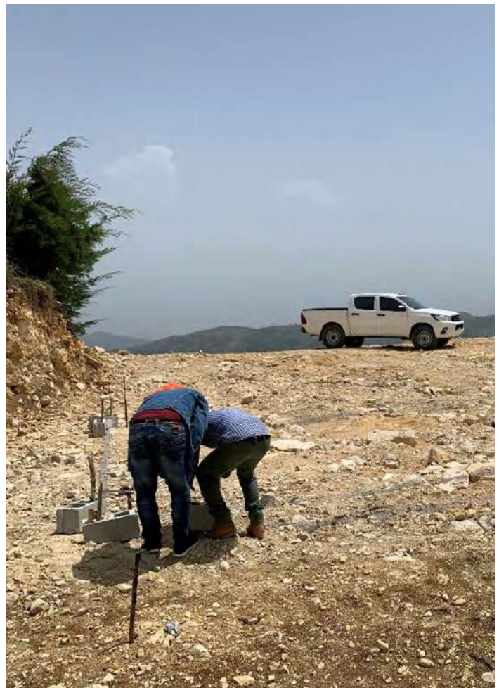
Trabajos de definición de las cimentaciones en el terreno de la microcentral fotovoltaica en Sabana Real.
