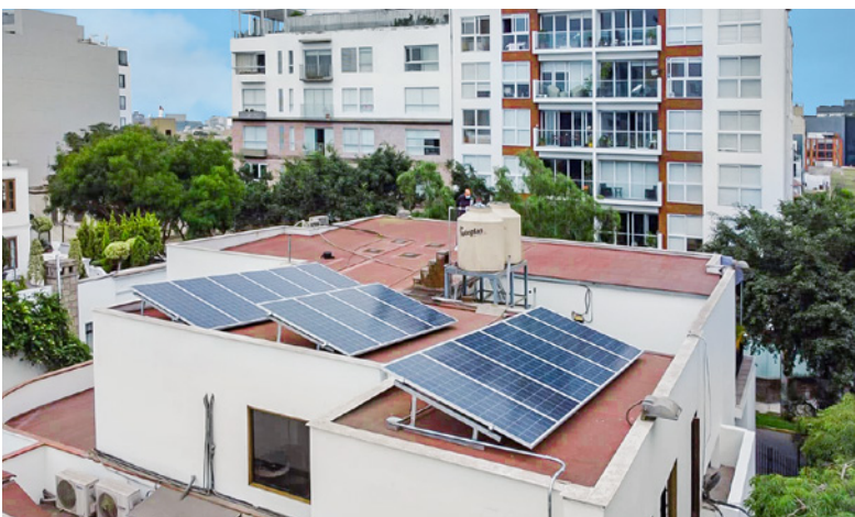
16 Solarpaneele versorgen mittlerweile das GIZ-Büro in Lima mit sauberem Strom.
