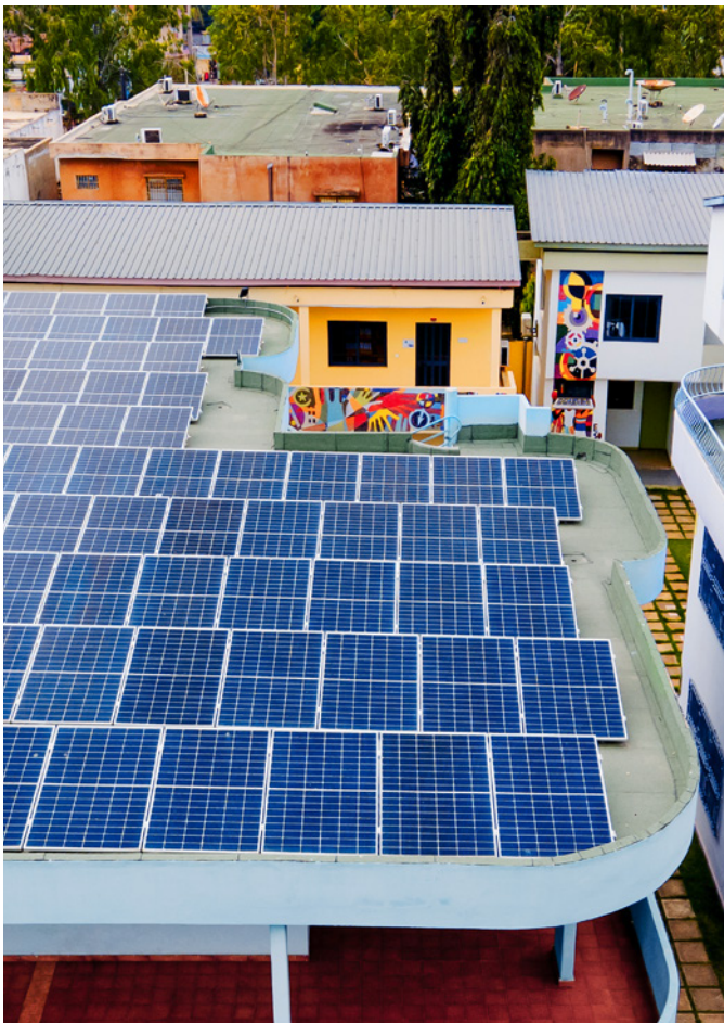
Die Photovoltaikanlage eines GIZ-Büros in Togo soll in den nächsten 30 Jahren 900 Tonnen CO 2 einsparen.
