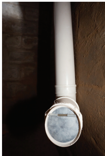
Зураг 7. Агааржуулалтын хоолойд хавхалга суурилуулсан байдал
